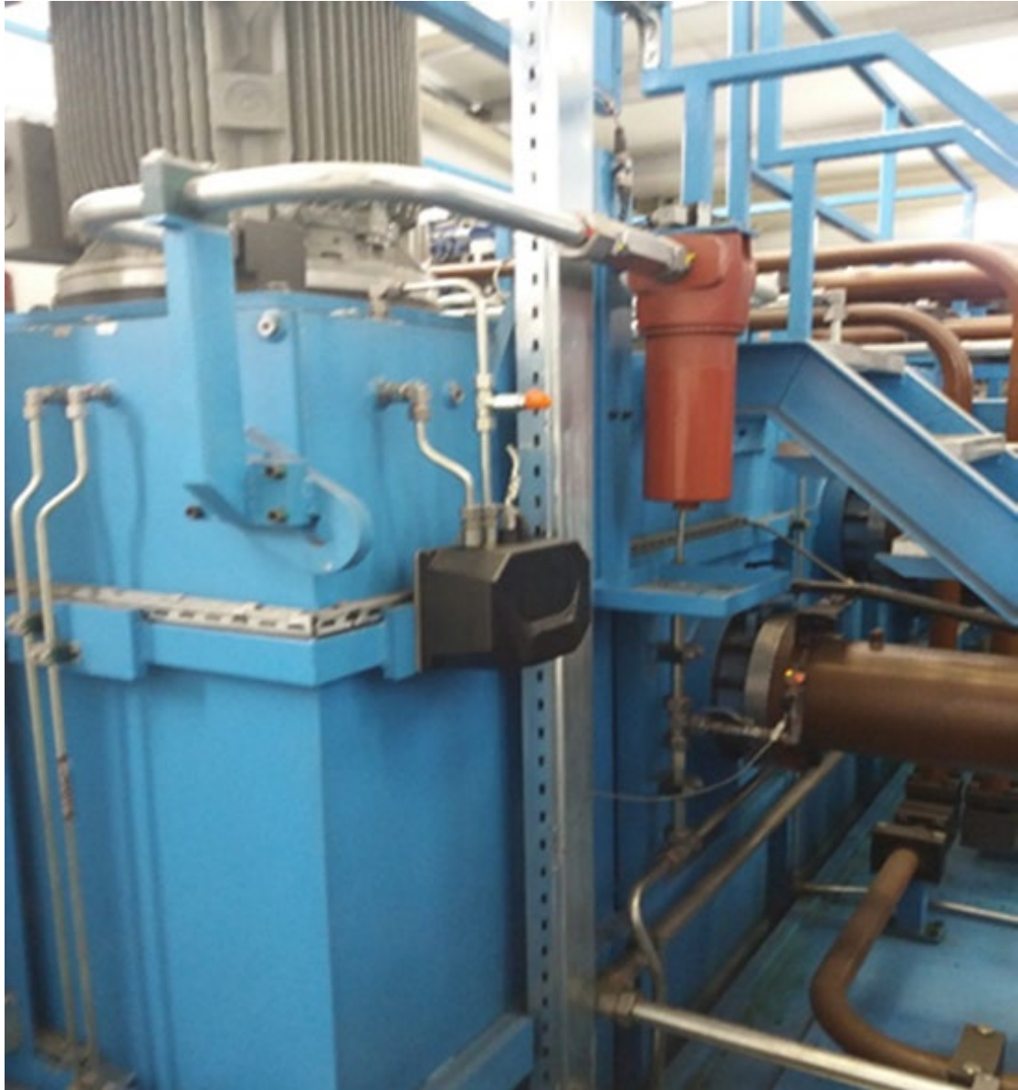
Detalle instalación en circuito de refrigeración de aceite hidráulico.
