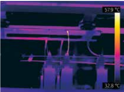
Cable de alimentación de transformador caliente
